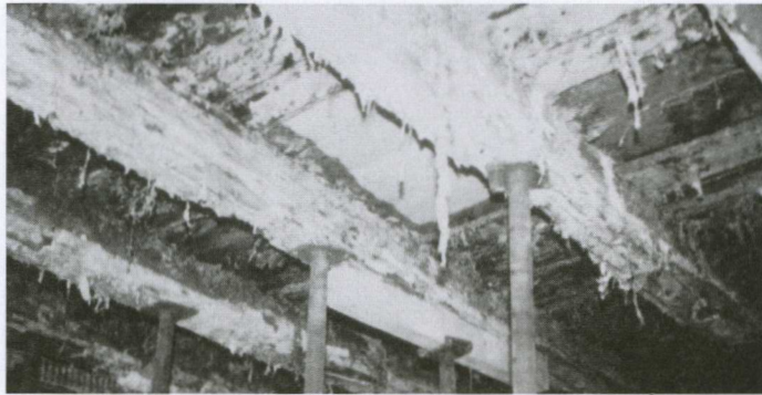
Abbildung: Hausschwammwachstum durch diffusionshemmende Fußbodenkonstruktion Quelle: FUSSBODEN ATLAS®
